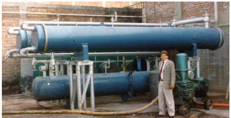
Condensadores de casco y tubo, enfriado por agua.
